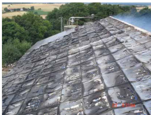
Bild 5: Photovoltaikanlage nach einem Brand (ohne Einsturz)
