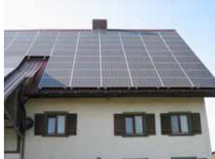
Bild 1: Photovoltaik-Anlage auf dem Dach eines Ökonomiegebäudes
